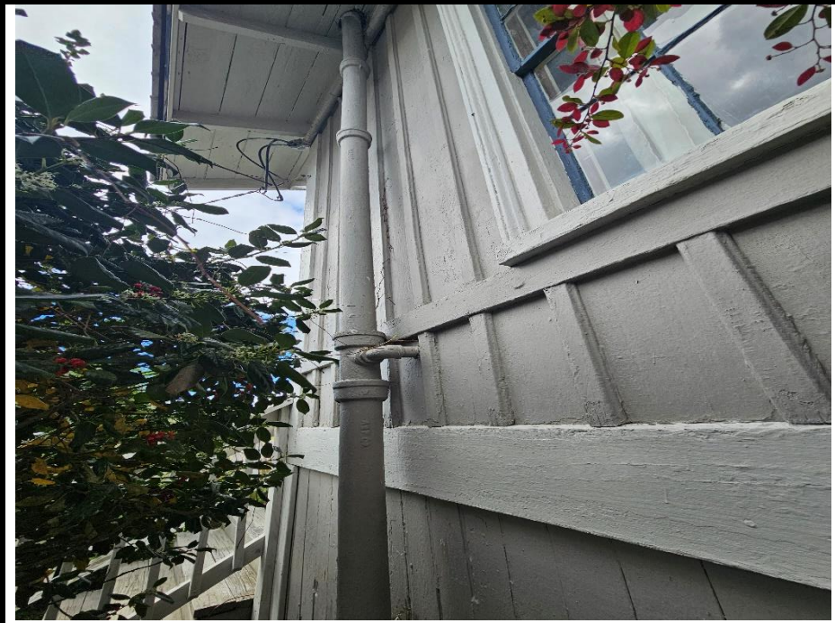
19. Gray Exterior Pipe
